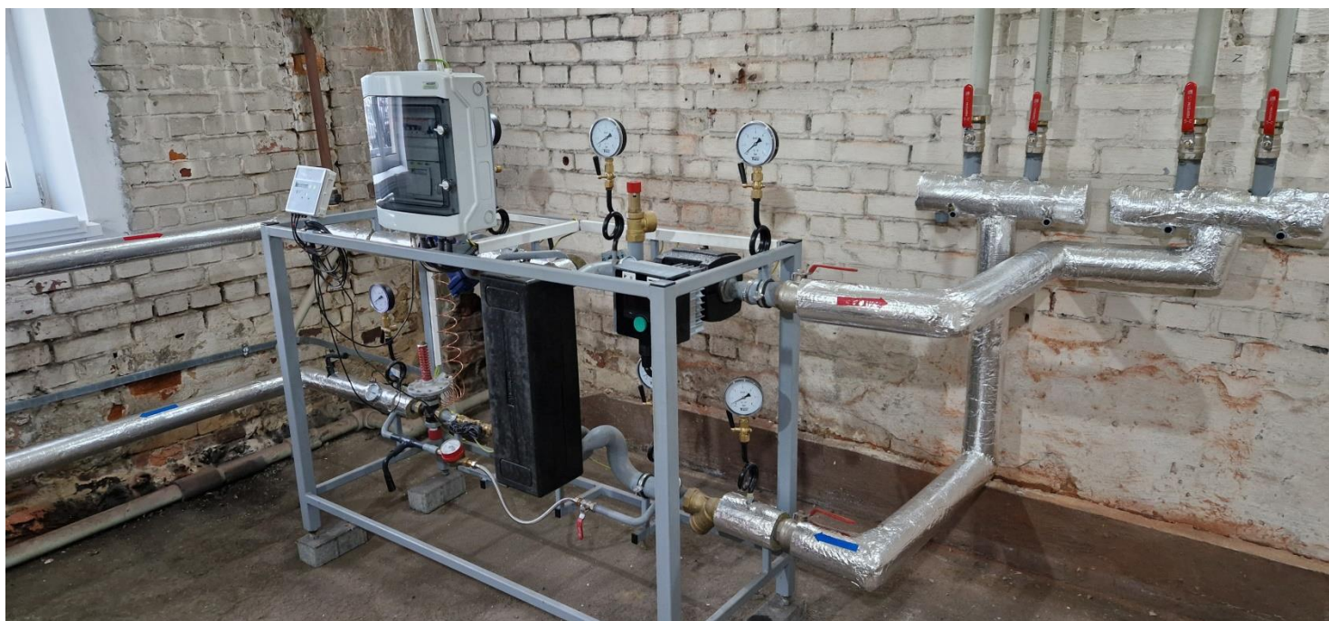
Modernizacja wężła ciepłowniczego w Urzędzie Miejskim w Zawadzkiem
